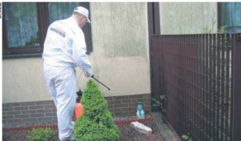
Zawsze podczas pierwszej wizyty pracownicy Myko Polska robią darmowy próbną oprysk na zakafekowanej powierzchni (w tym przypadku ze ściany budynku trzeba było usunąć mech)
